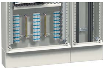
Terminais de conexão e de terra no fundo do armário
