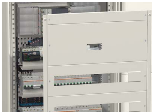
Os espelhos proporcionam um acesso seguro aos dispositivos de manobra dos equipamentos.
