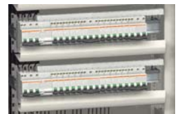
Pente de conexão
